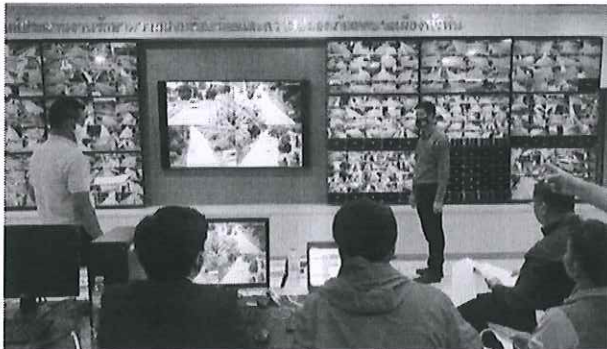
(ทม.หัวหิน-ติดตั้งCCTV)
